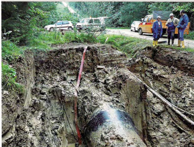
BILD 4: Mit dem SmartBall™ auf einen Meter genau detektierte undichte Muffenverbindung (Foto: Thomas Pohl)
